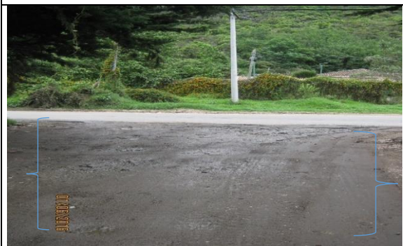
Foto 3: De acuerdo a la imagen se evidencia la ausencia de material de fresados o el tratamiento superficial doble.
