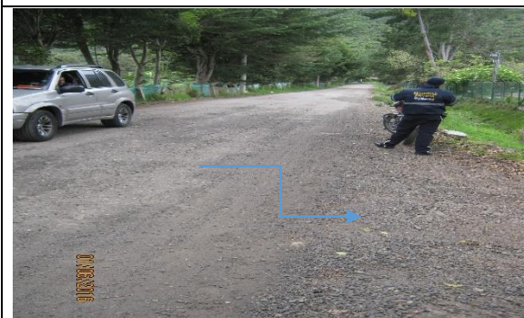
Foto 5: De acuerdo a la imagen se evidencia la ausencia de material de fresados o el tratamiento superficial doble.
